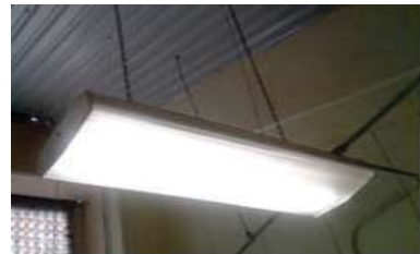
Figura 3. Sistema de iluminación de la empresa.
